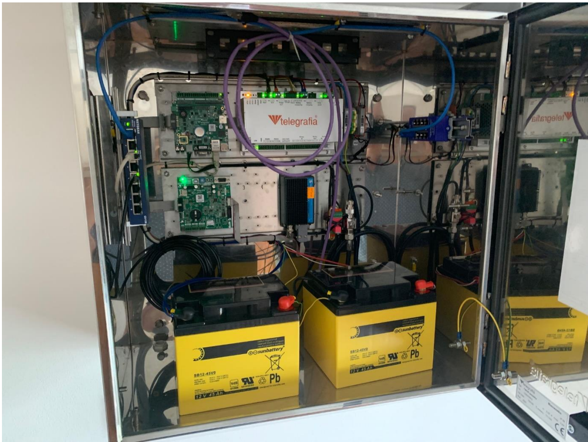
Riadiaca jednotka systému
